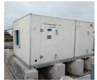
央行数据中心
